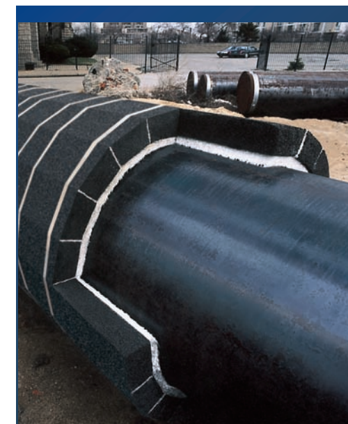
O isolamento FOAMGLAS® foi instalado como parte de um sistema composto de isolamento. Incorpora uma camada de uma polegada de feltro de fibra de vidro aplicado diretamente em torno do tubo e coberto com o isolamento FOAMGLAS®.
