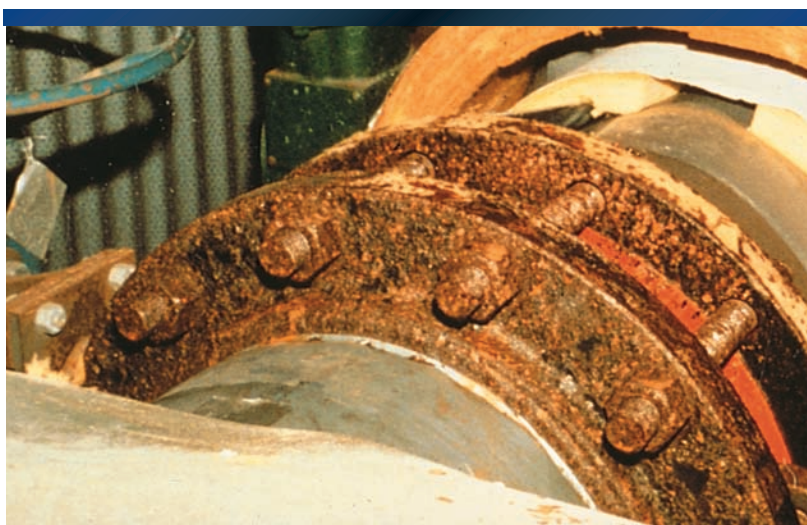
Um flange corroído sob isolamento absorvente.
