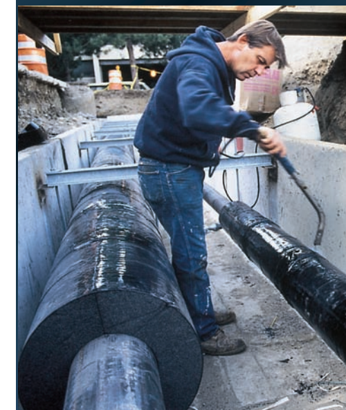
As seções StrataFab® foram instaladas em sequência, juntadas ponta a ponta (com a colocação de cintas PITTWRAP® nas interfaces) e seladas a quente.
